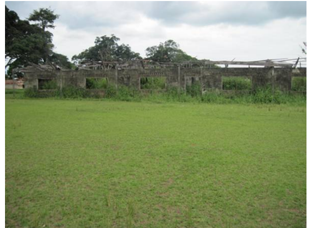
Photo 48 : Collège de Kindamba : l'internat détruit.
