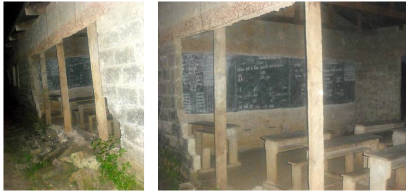
Photos 42 : L'état des locaux de l'école de Moussolo Dakar.
