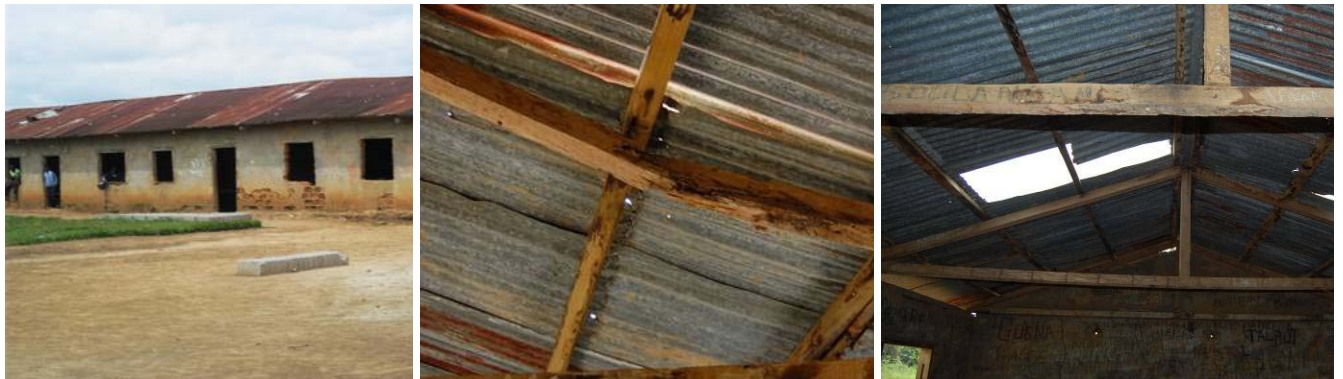
Photos 43 : L'état des locaux de l'école de Kilebe Moussia. maçonnerie dégradée, charpente endommagée, trous dans la couverture
