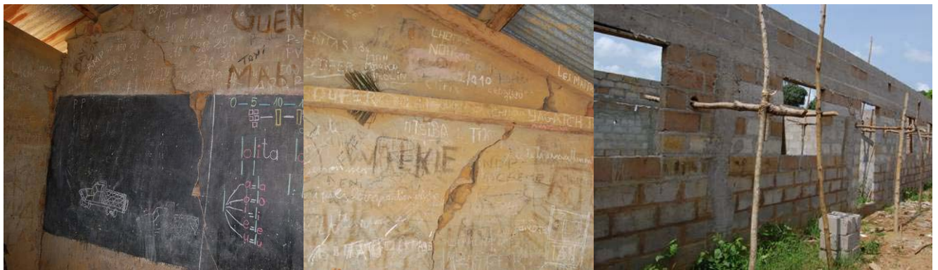
Photos44 : Anciennes salles de classe à réhabiliter ? (Kilebe Moussia).
