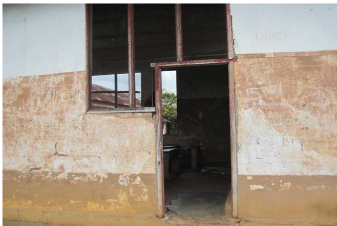
Photo 50 : Collège de Kindamba : Les ouvertures, tableaux et murs.
